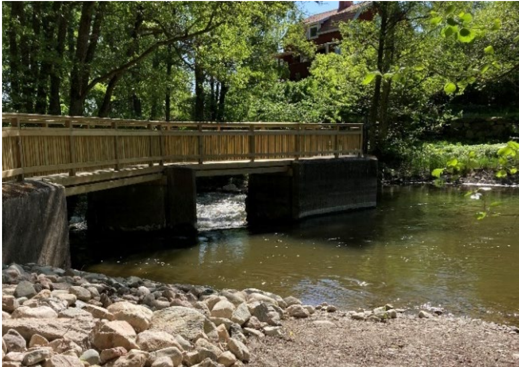
Figur 5. Nygårdsdammen i maj 2023 efter restaurering (från andra sidan) där sättarna i utskovet tagits bort. Natursten har även tillförts nedströms för att skapa en upptröskling som tar upp fallhöjden. Bron vid dämnet ersattes av en ny för att öka tillgängligheten.
